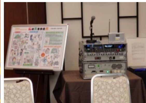
臨時災害放送局設備
